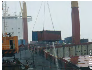
Récupération de conteneurs effondrés
