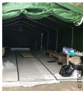
Exemple d'équipement sur un site de nettoyage
